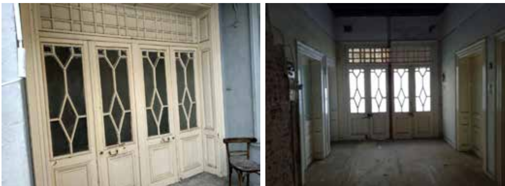
Εικ. 5: Εσωτερική άποψη του παλιού κουφώματος εισόδου. Διακρίνονται τα ίχνη του κατεδαφισθέντος διαχωριστικού.
